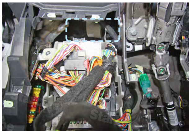
Фото 5. Пример расположения центрального блока охранно-телематического комплекса
