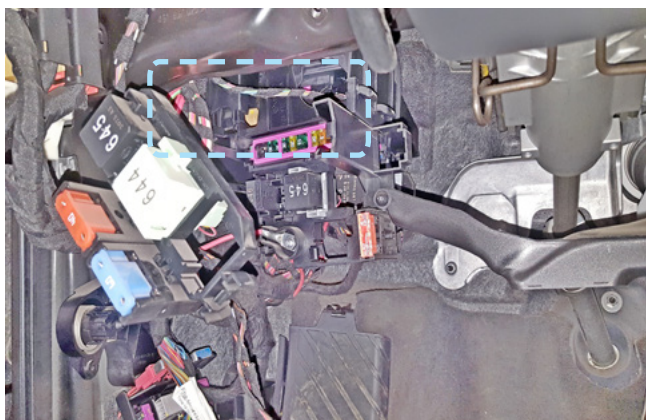
Фото 2.8. Пример расположения центрального блока охранно-телематического комплекса
